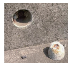
モルタルの剥落
